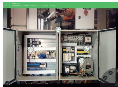
Armario eléctrico abierto virtualmente
